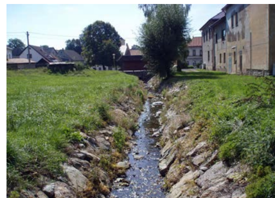
Příklad odtrubnění potoka, Tresný potok
