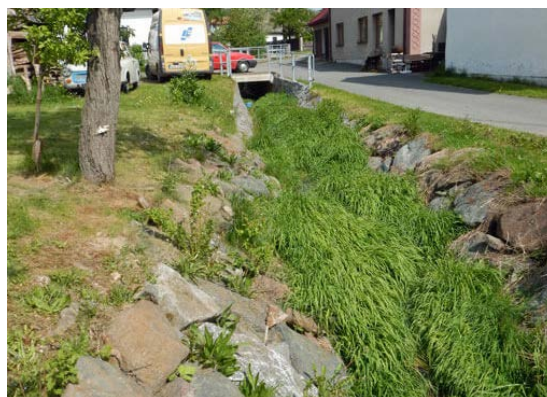
Příklad odtrubnění potoka, Tresný potok
